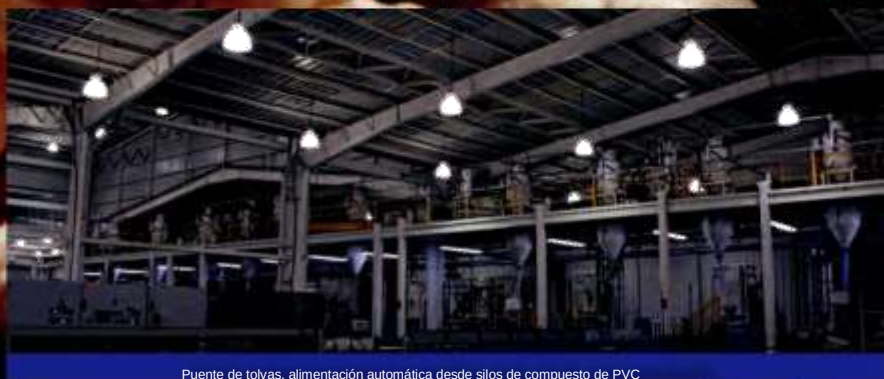
Puente de tolvas, alimentación automática desde silos de compuesto de PVC
