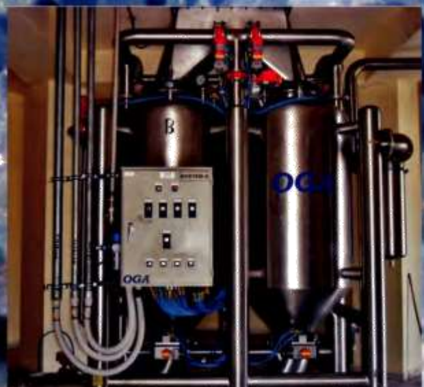
Sistema fase densa continuo instalado en Siria para refinería de azúcar. Flujo 70 ton/h
