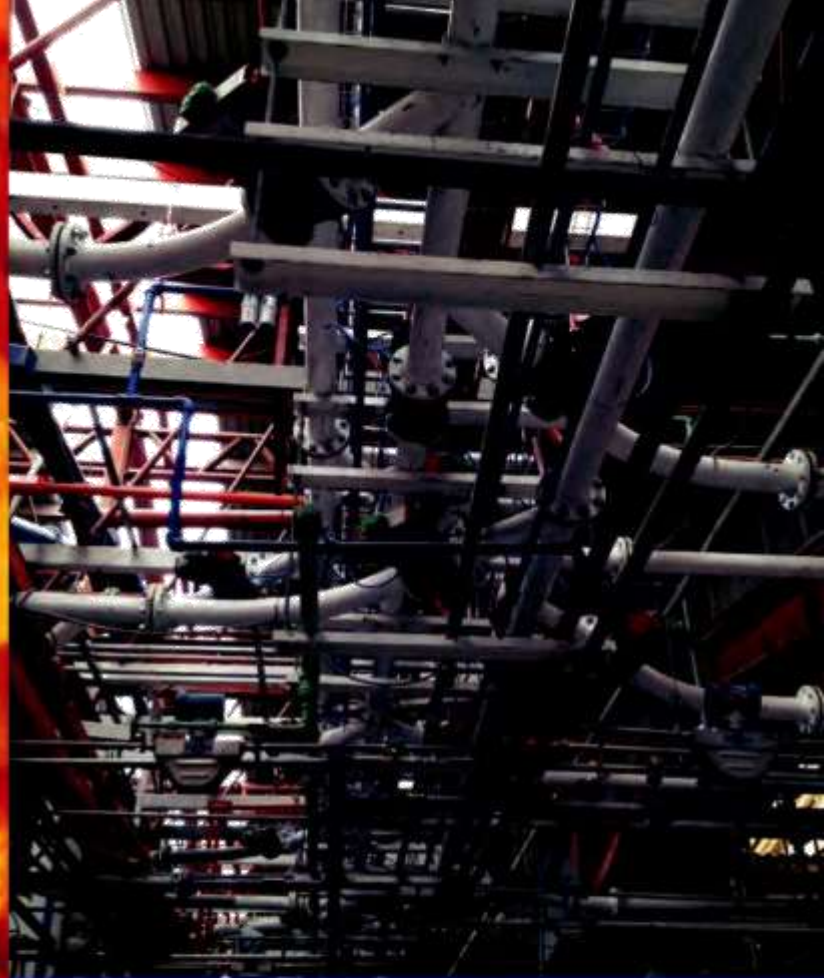
Red de distribución de carbonato de sodio, carbonato de calcio y bentonita a 3 basculas que alimentan 10 mezcladores de polvos
