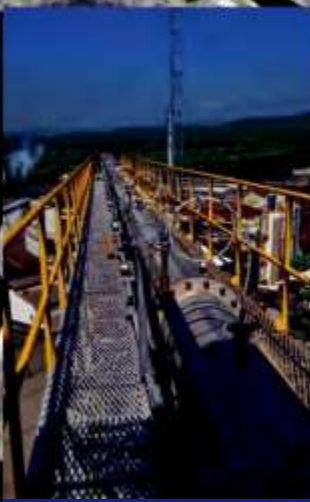
Ruta de tubería transporte de azúcar. Flujo total 60 ton/h
