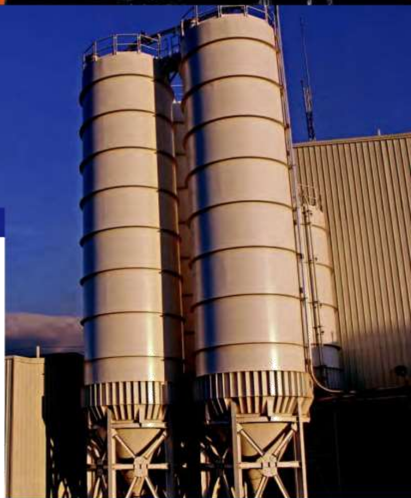
Batería de silos de 325m 3 para almacenamiento de PVC y CaCO 3 a línea de mezcla compuesta de PVC, flujo de proceso de 2 torres
