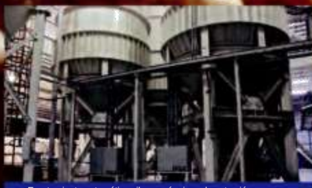
Enrutamiento automático silos a máquinas de extrusión
