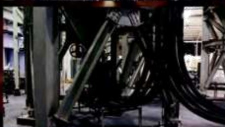
Silos de almacenamiento de compuesto de PVC con pesaje
